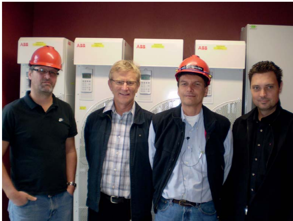
Ola Hallenheim, Mats Andersson, Peter Struve, och Björn Hasselqvist i det ställverk som byggts ut för att rymma delar av den nya utrustningen för att få effektivare energistyrning.
