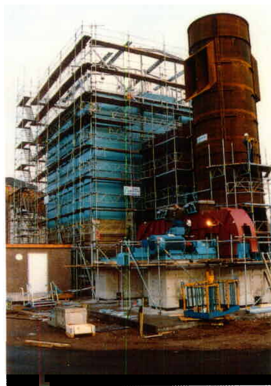
Stora miljöinvesteringar görs i Halmstad. Filteranläggningen är t ex betydligt större än Pulverkets i Höganäs.
