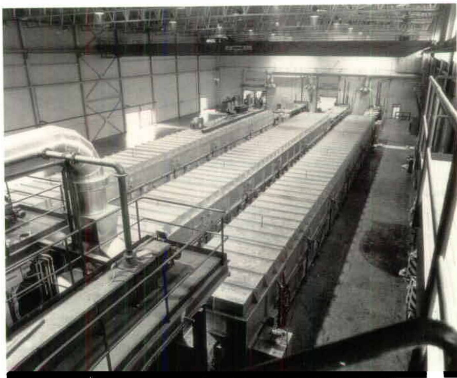
Ugnshallen med de tre bandugnarna. Distaloypulver tillverkas genom att järnpulver legeras med nickel, koppar och molybden genom värmebehandling i bandugn.
