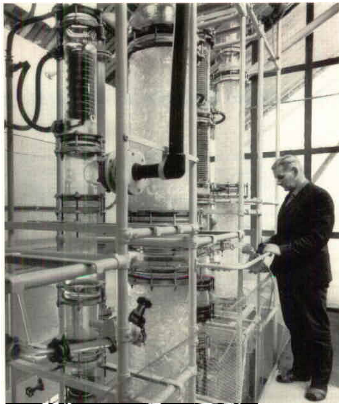
Absorptionsanläggningen för saltsyra och svaveldioxid är ett glit- ter av glasrör och -behållare. Förman Allan Johannesson ser till att förskruvningarna sluter tätt.
